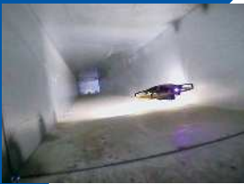
ダクト・配管内部
